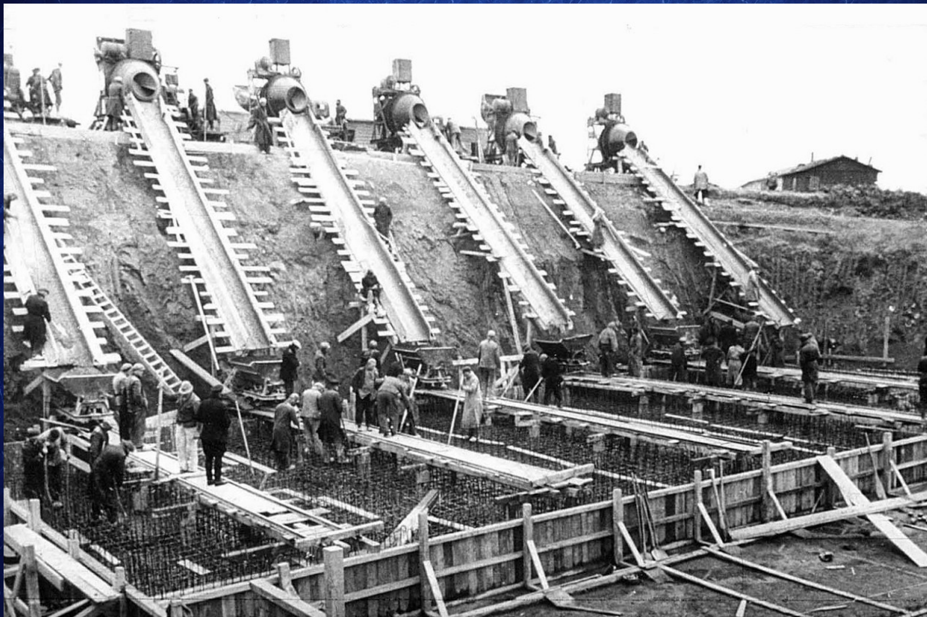
Travailleurs affectés à la construction d'une casemate de batterie Todd près de Calais dans le cadre de l'édification du mur de l'Atlantique
