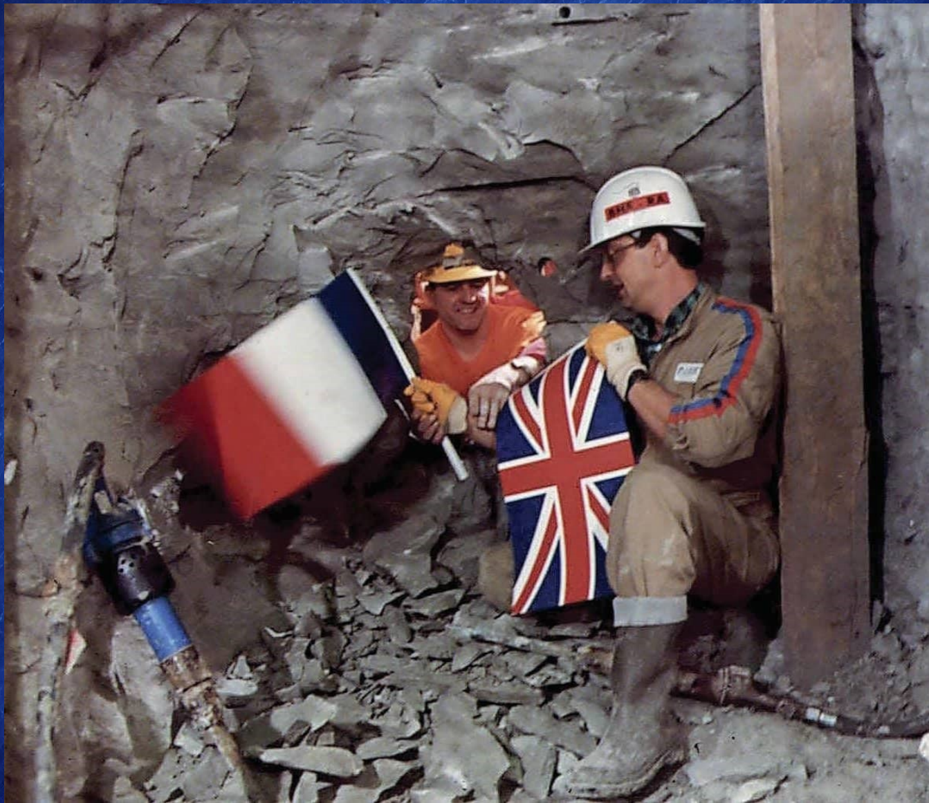
Le 1 er décembre 1990 à 12h12, deux ouvriers foreurs, l'un britannique, l'autre français, échangent une poignée de main historique au point de jonction des deux tunneliers sous la Manche à 15,6 km de la France et à 22,3 km du Royaume-Uni
